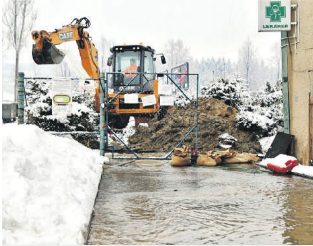
Poškodené vodovodné potrubie spôsobilo menšiu potopu. FOTO: MSÚ
