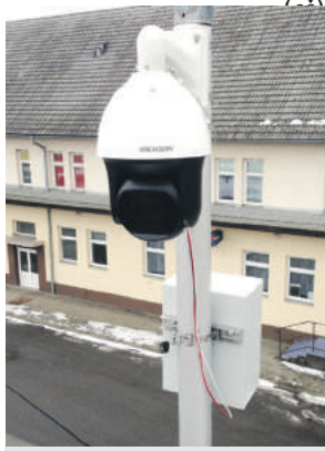
Kamera na autobusovej stanici. FOTO: MSÚ
